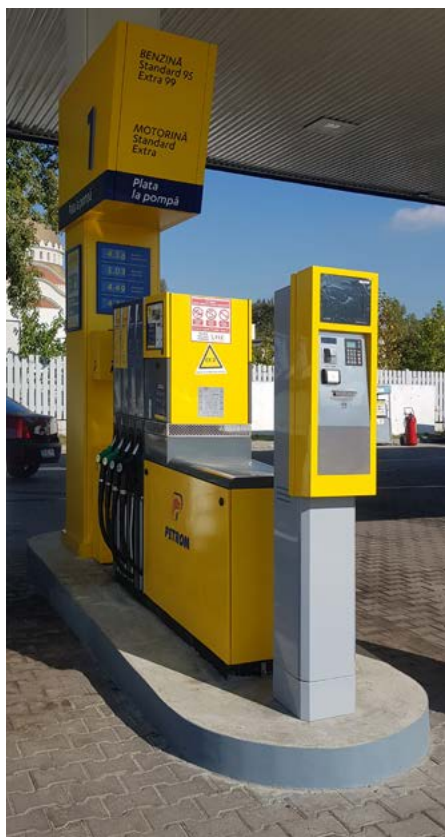
Tankovací automat CardManager na čerpací stanici rumunské sítě Petrom
